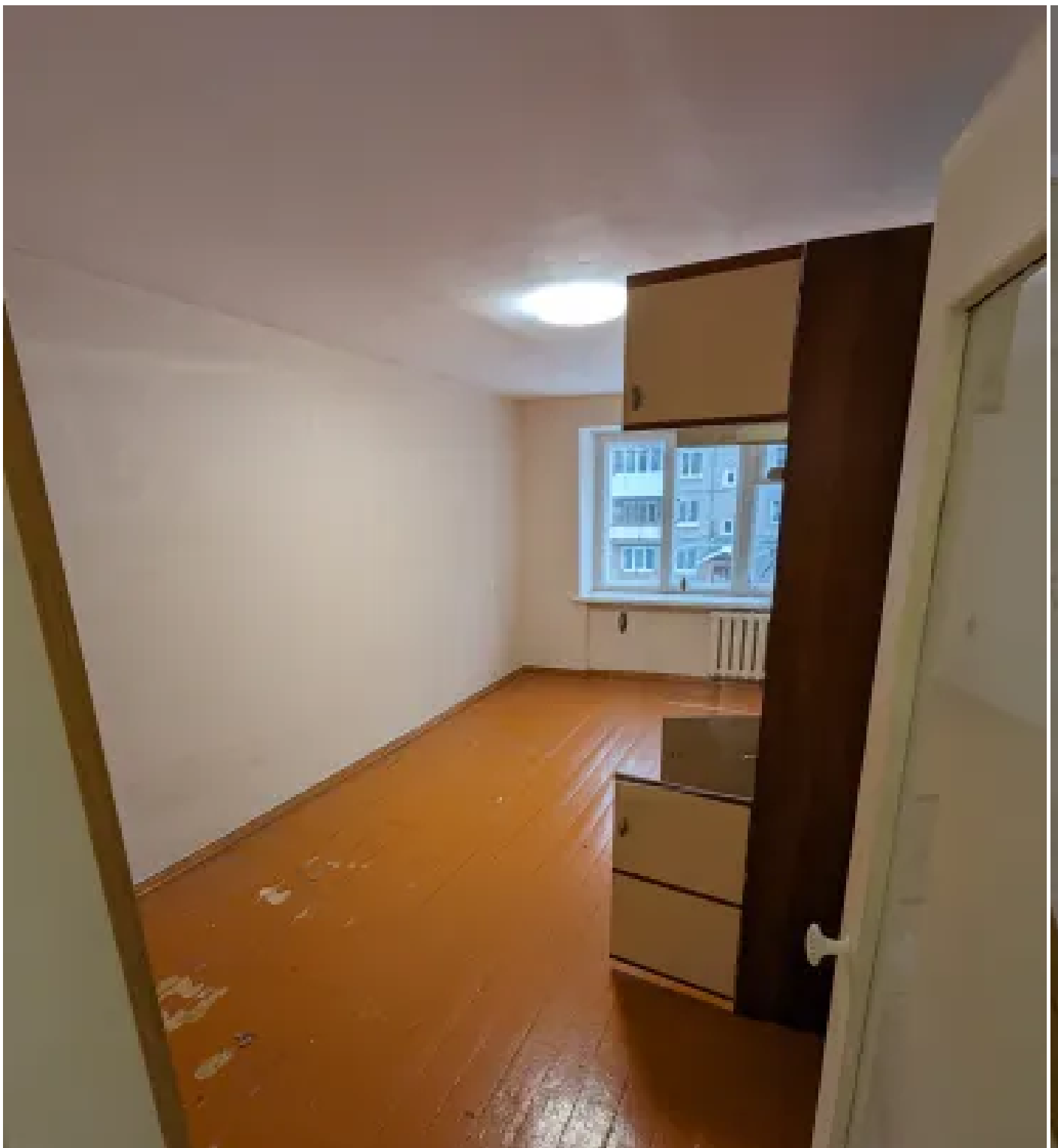
1/6 Так выглядел пол до ремонта
